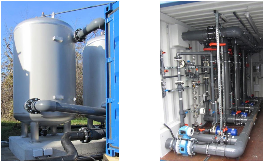
Abbildung 8: Ozonreaktor 1 (links) und assoziierte Verrohrung sowie Ozoneintragssystem (rechts)
