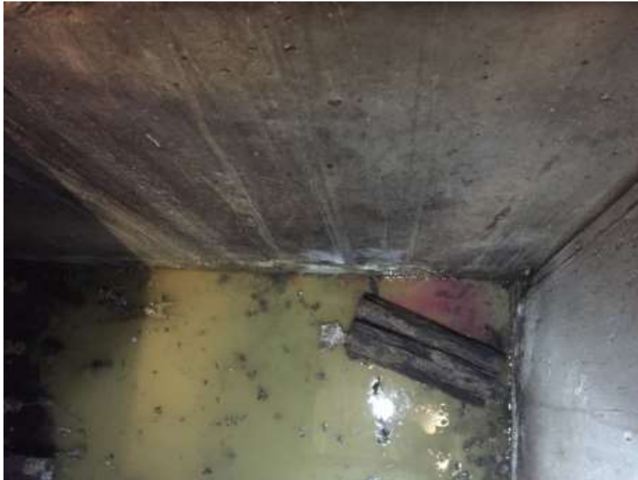
Abbildung 63: Undichter Schacht im Gebäude mit eingetretener Suspension erkennbar an der violetten Färbung durch das Kaliumpermanganat
